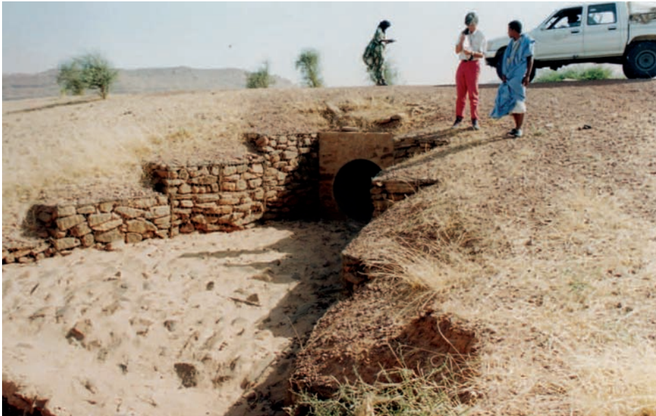
Photo 17: Vue de l'aval de la conduite de vidange du barrage d'Aweinat Ar (Tagant); noter la protection efficace du bassin de dissipation en moellons posés à bain de mortier (le raccordement au lit mineur n'est toutefois pas satisfaisant car des affouillements sont apparus).
