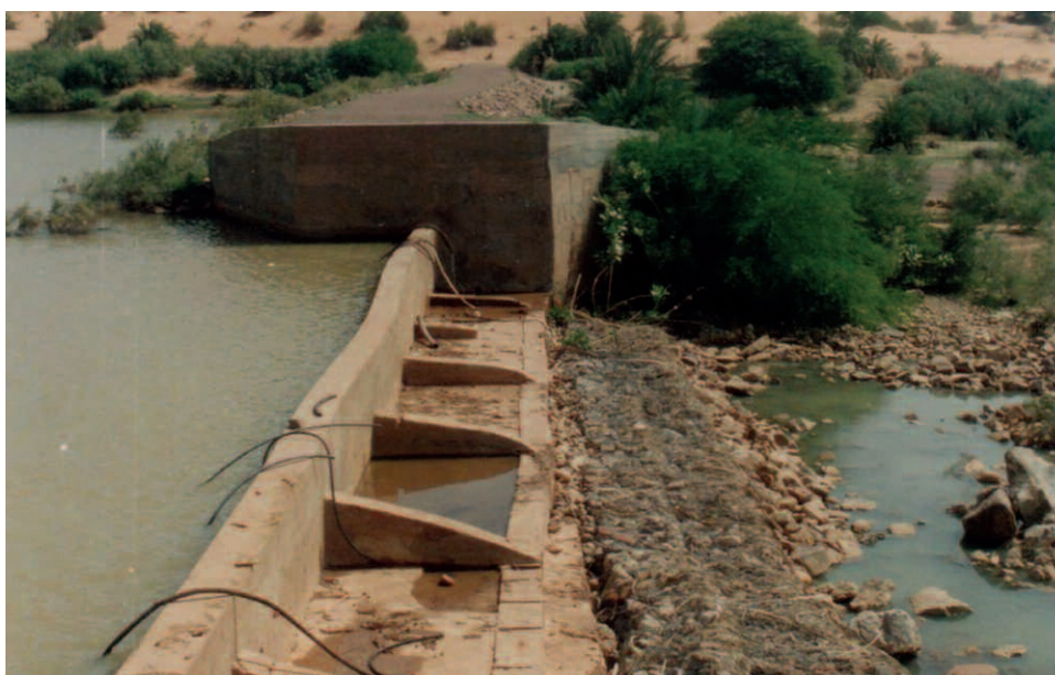
Photo 3: Barrage de Teyarett (Adrar). Prises d'eau rudimentaires par siphons (tuyaux simplement disposés par-dessus l'évacuateur de crues).
