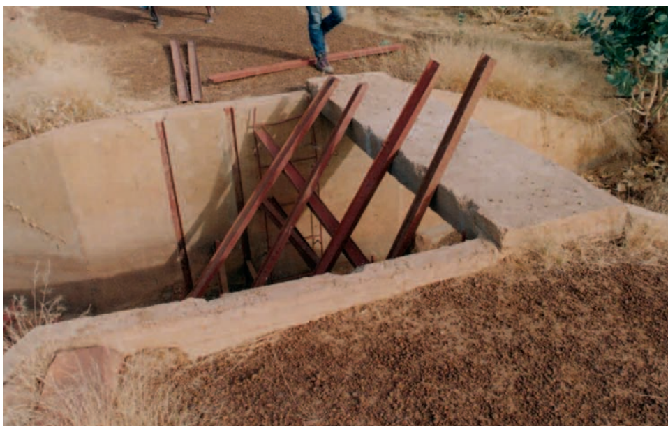
Photo 15: Ouvrage de vidange "classique" en béton. Barrage de Boukheikhil (Hodh el Gharbi).
