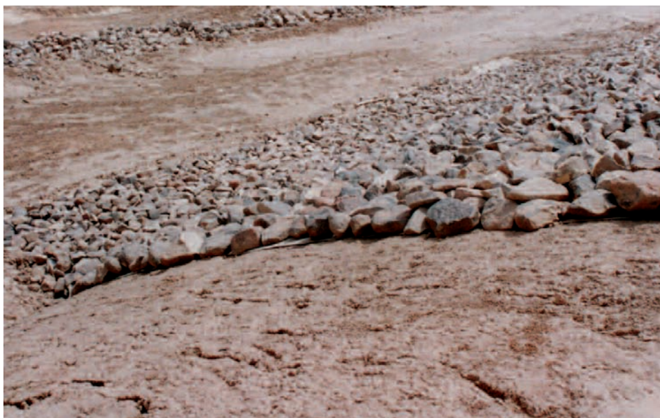
Photo 4: Pose d'un perré amont sur un géotextile (barrage de Vété, Assaba), une solution valable lorsqu'elle est correctement réalisée... ce qui n'est pas le cas de ce barrage. Il faut en effet interposer une couche de pose entre le remblai et le géotextile; en outre, la surface de ce remblai aurait dû être reprise car elle est déjà entaillée par des ravines d'érosion dues aux pluies survenues en cours de chantier.
